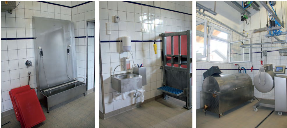
Genügend Platz auf engem Raum: Knifflig bei der Konzeption war die Platzierung des Zutriebs bei strikter Trennung von Schwarz- und Weiß-Bereichen. Das gelang am Ende unter anderem durch eine eigene Bodenrinne in der Tötungsfalle. Fotos: si
